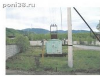
ДЕЙСТВУЮЩАЯ ТРАНСФОРМАТОРНАЯ ПОДСТАНЦИЯ наружной установки тип КТПН - 400/6/0,4
